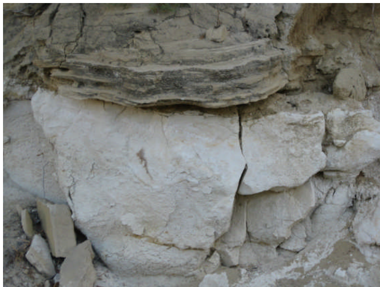
Foto n. 11 – Particolare dell'ammasso trubaceo fratturato a rischio di frana di crollo
