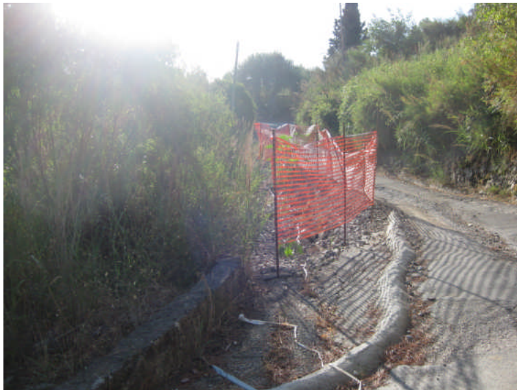
Foto n. 9 – Particolare della strada - via Landro- interessata dal dissesto complesso
