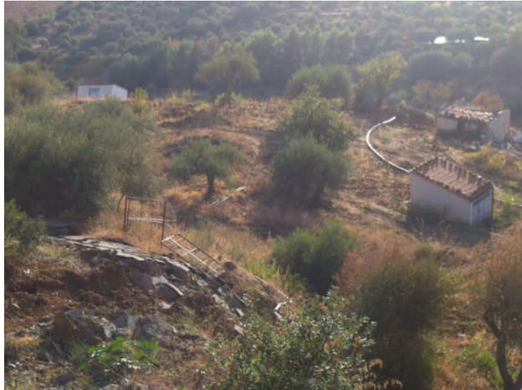
Foto n. 4 – Dissesto di c/da Olivazza con evidente il materiale detritico-argilloso scivolato
