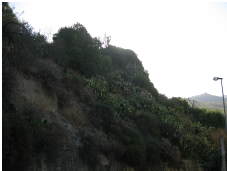
Foto n. 1 – Costone roccioso (calcarei trutacei) presente a monte di via Europa Unita
