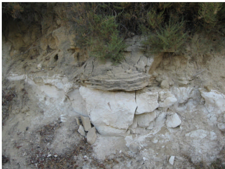
Foto n. 6 – Particolare della fatturazione dell'ammasso calcareo trabaceo oggetto di crollo
