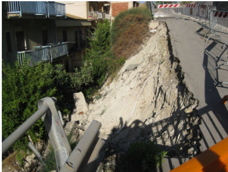
Foto n. 7 – Particolare del collasso della porzione di sede stradale di via Europa Unita
